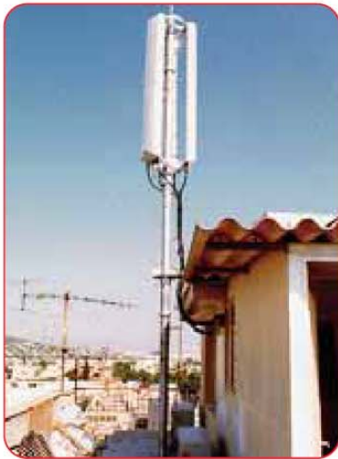
Σταθμός βάσης σε αστική περιοχή
